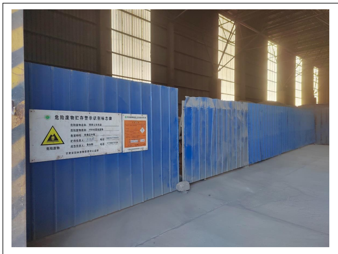
图 4.1-5 危废贮存库设施
