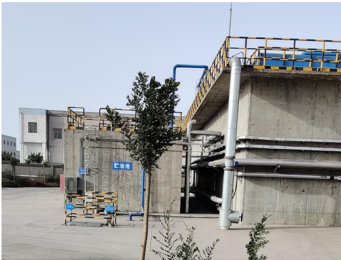
图 3-28 焦化厂酚氰废水处理站内主要设备
