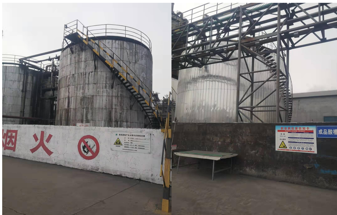
焦化厂焦油储罐
