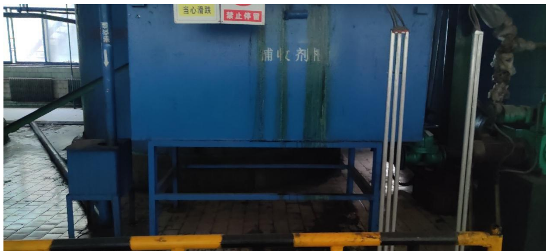
图 3-7 选矿厂储罐及储槽
