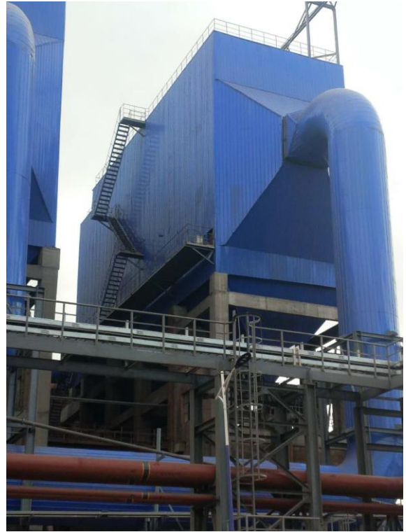
#2 球团竖炉电除尘器
