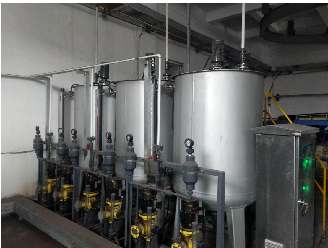
脱硫废水加药装置
