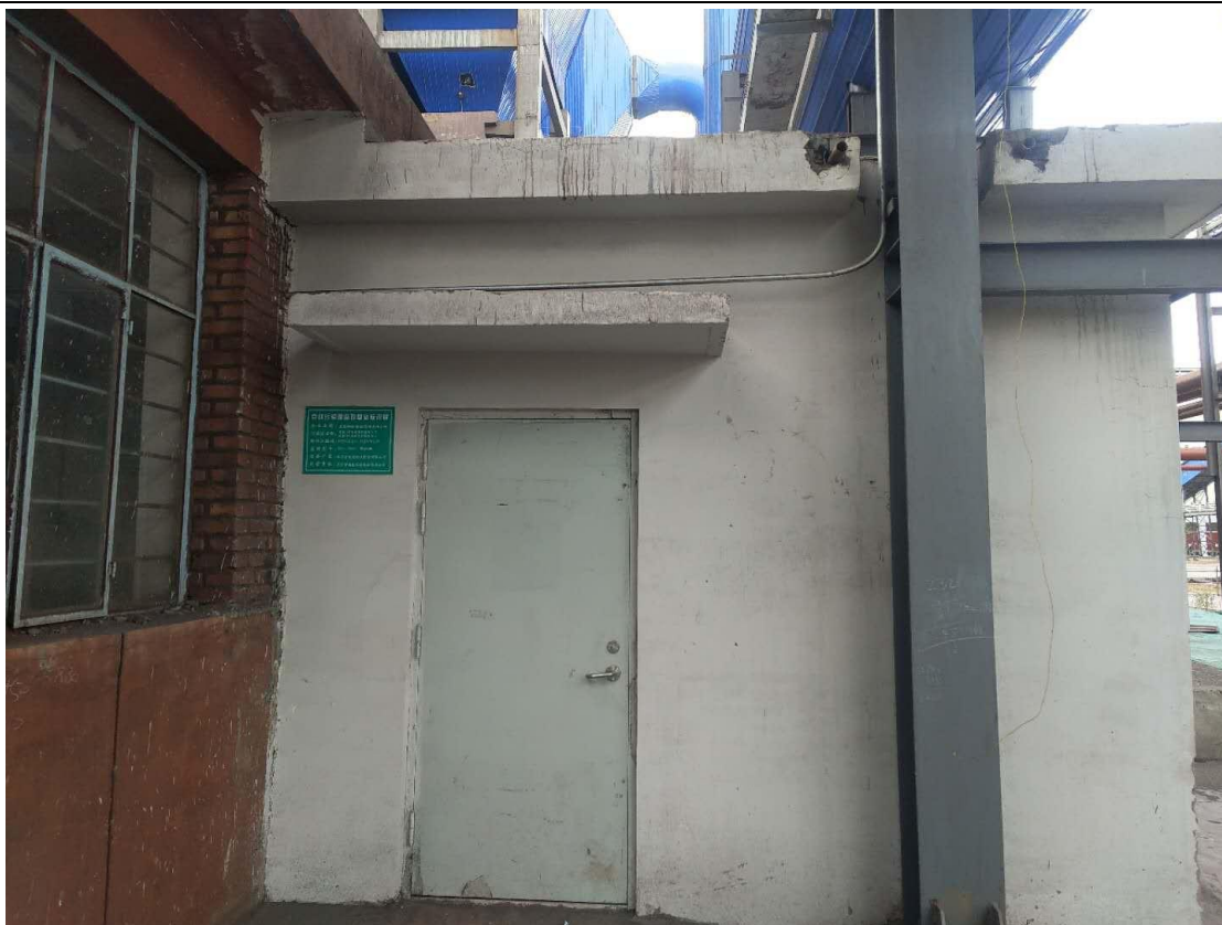
#1、#2 球团竖炉脱硫入口 CEMS 室
