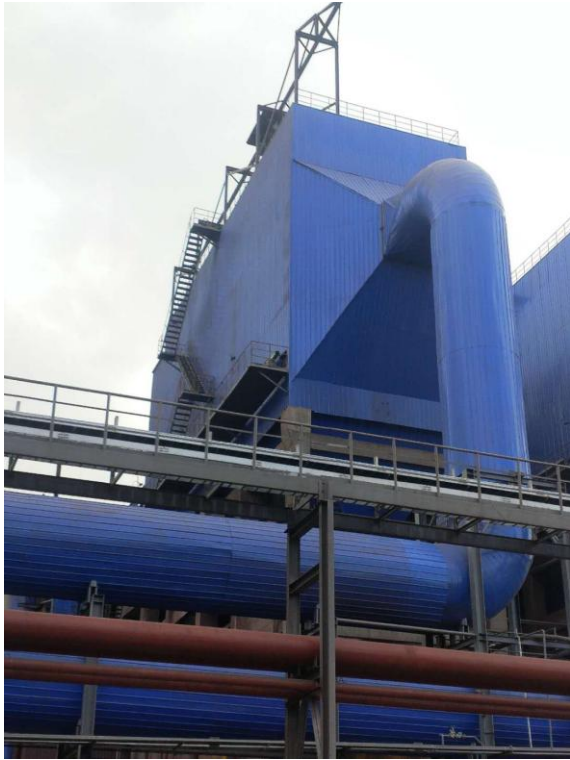
#1 球团竖炉电除尘器
