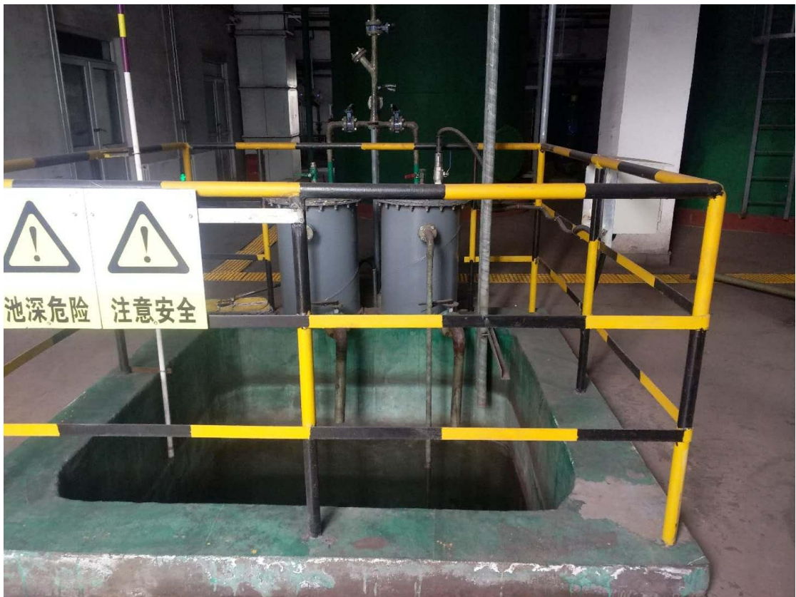
脱硫废水清水池
