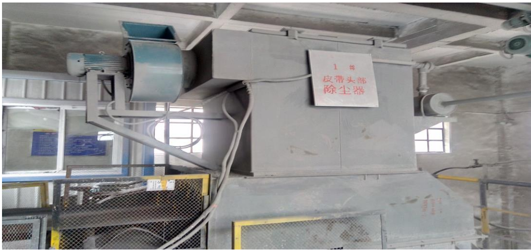
1#皮带机头处除尘器
