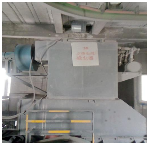
3#皮带机头处除尘器
