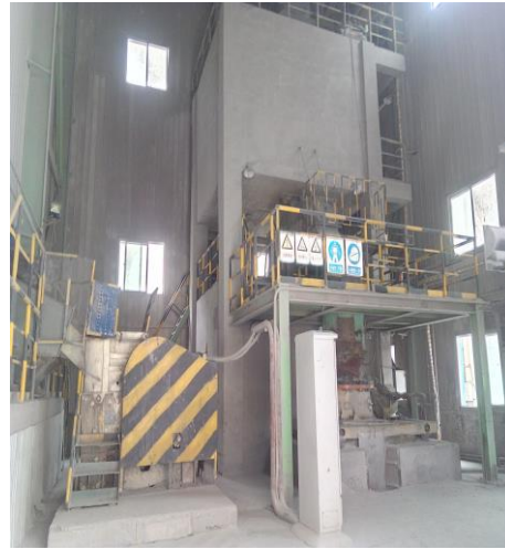
破碎车间内部
