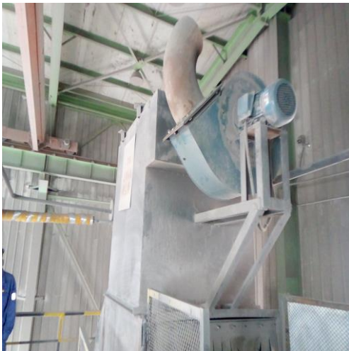
2#皮带机头处除尘器
