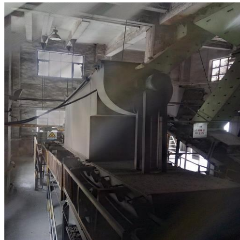
2#皮带机尾处除尘器
