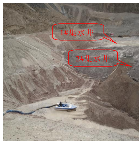
集水井、排洪围船及管道
