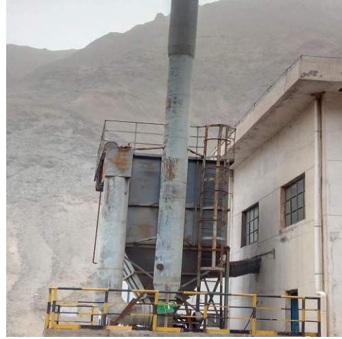
筛分车间北侧的除尘器
