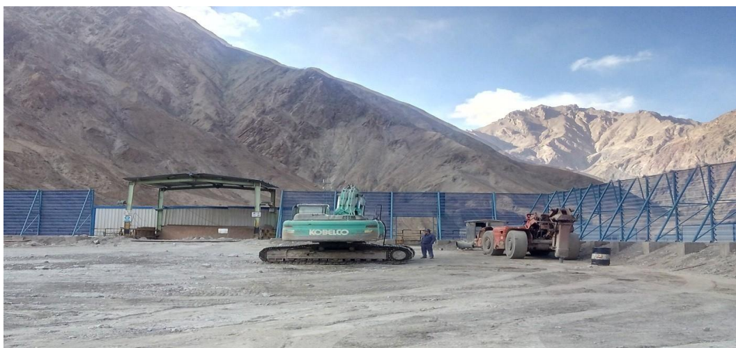
原料堆场防风抑尘网
