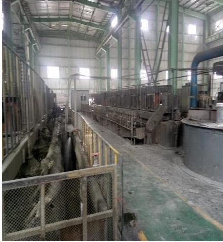
浮选车间内部
