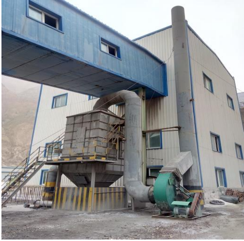
破碎车间北侧的除尘器
