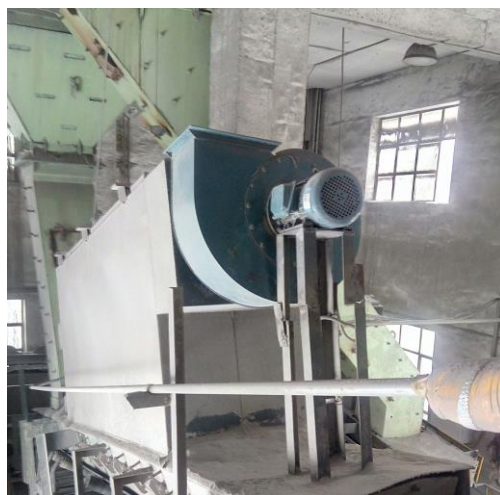
3#皮带机尾处除尘器
